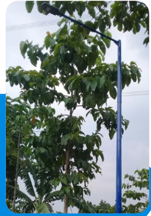
Tiang PJU Tipe J + Lampu tenaga surya
