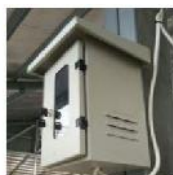
Box Meteran Listrik Custom
