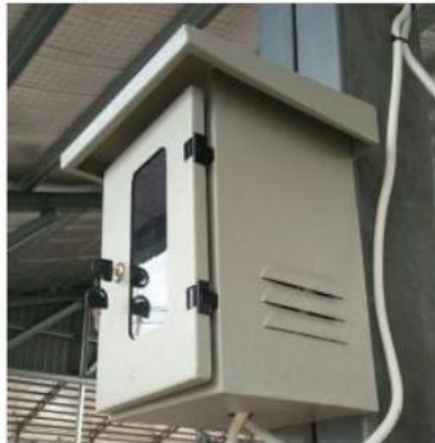
Box Meteran Listrik Custom
